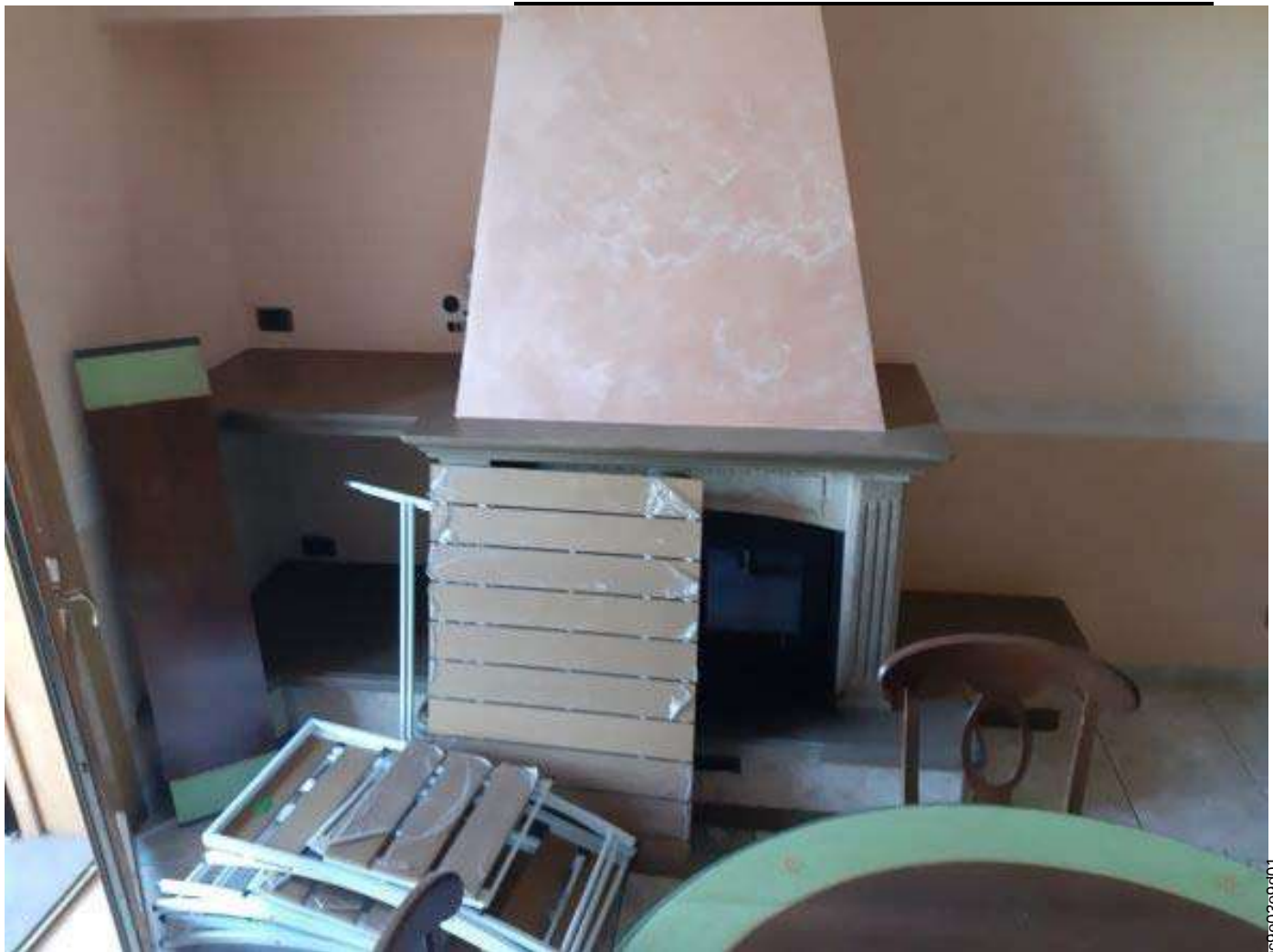
FOTO n. 13- Particolare del termocamino
