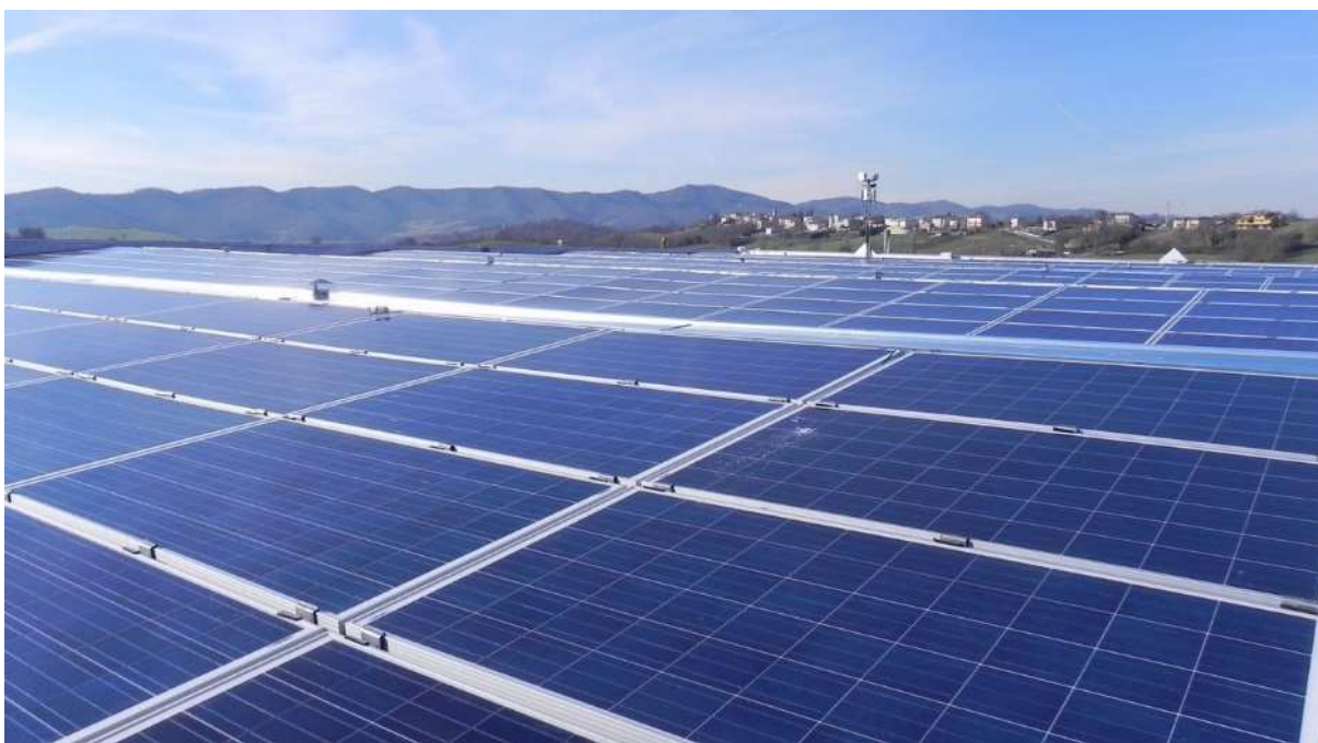
Particolare copertura fotovoltaica Edificio 2
