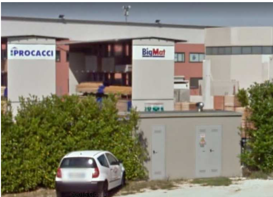
Cabina di consegna Enel con ingresso da Via Artigianale (da Google Maps)
