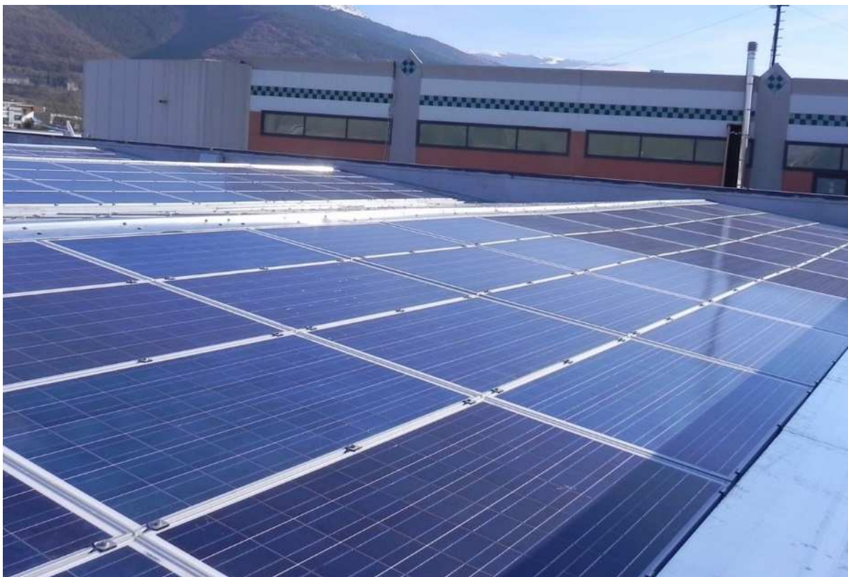
Particolare copertura fotovoltaica Edificio 1
