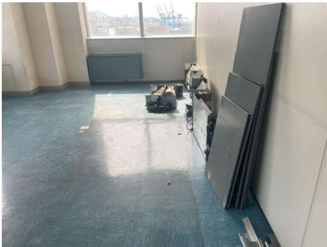
Fan coil smontati
