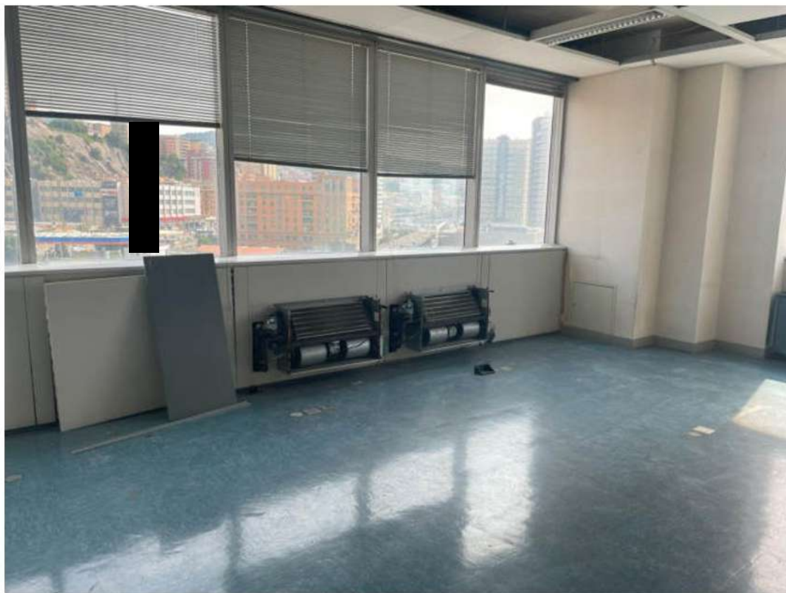
Fan coil smontati
