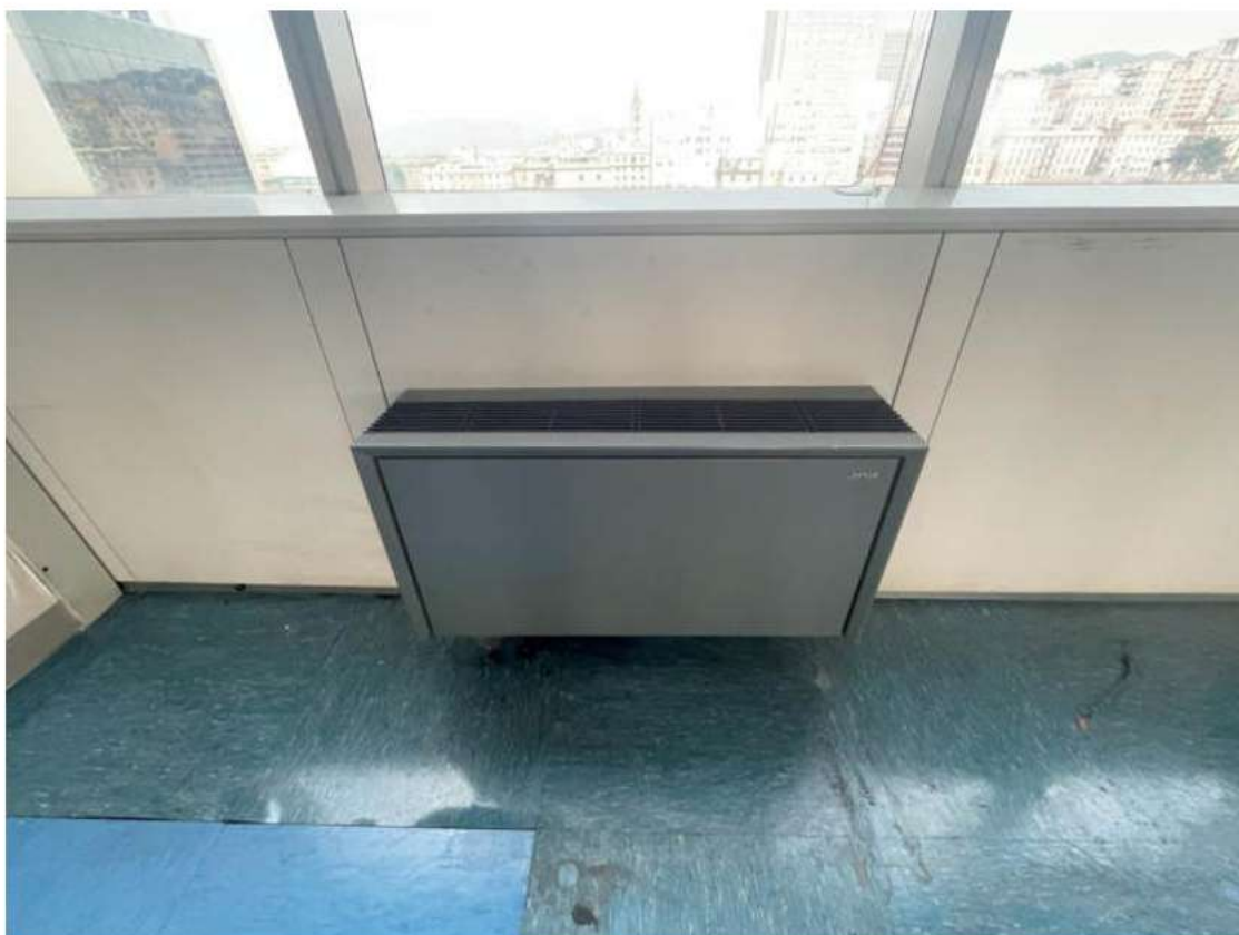
Particolare fan coil di impianto climatizzazione centralizzato ad oggi non funzionante
