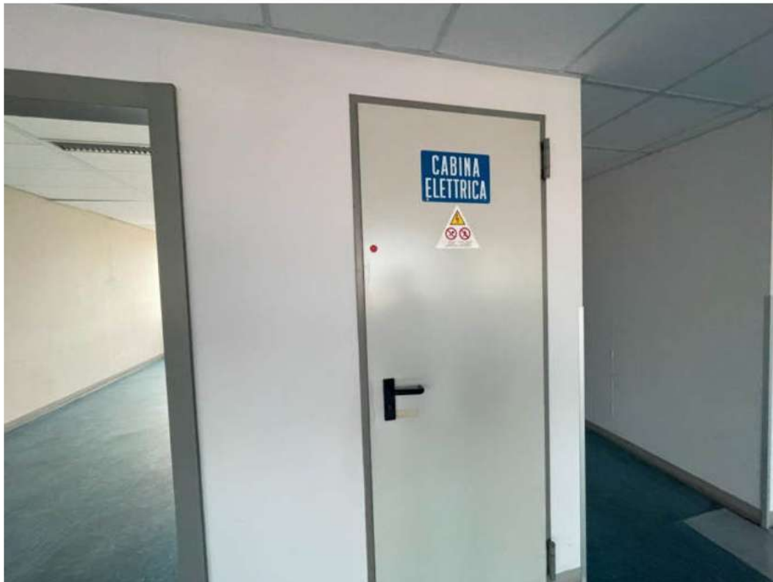
Ingresso cabina elettrica
