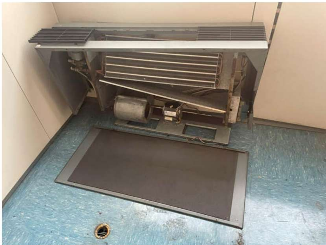
Particolare ventilconvettore (fan coil) smontato e non funzionante
