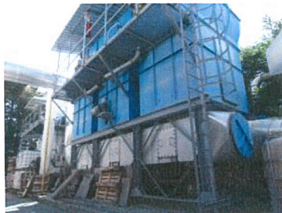
Foto 10, post combustore termico
