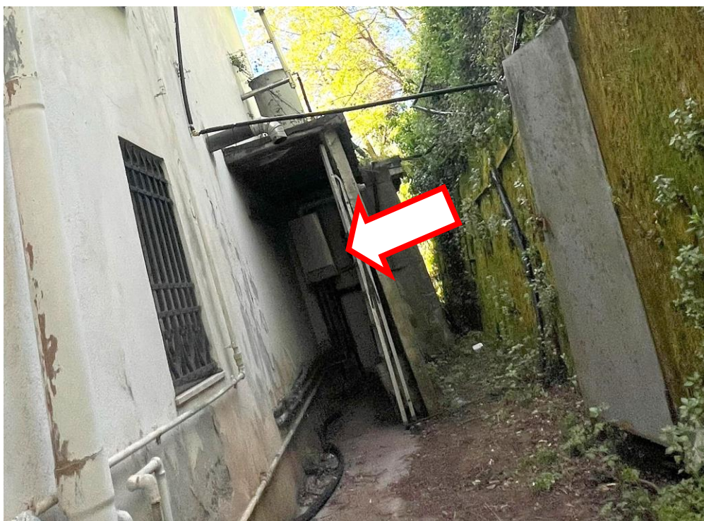
Foto n 9. - Locale abusivo da demolire
