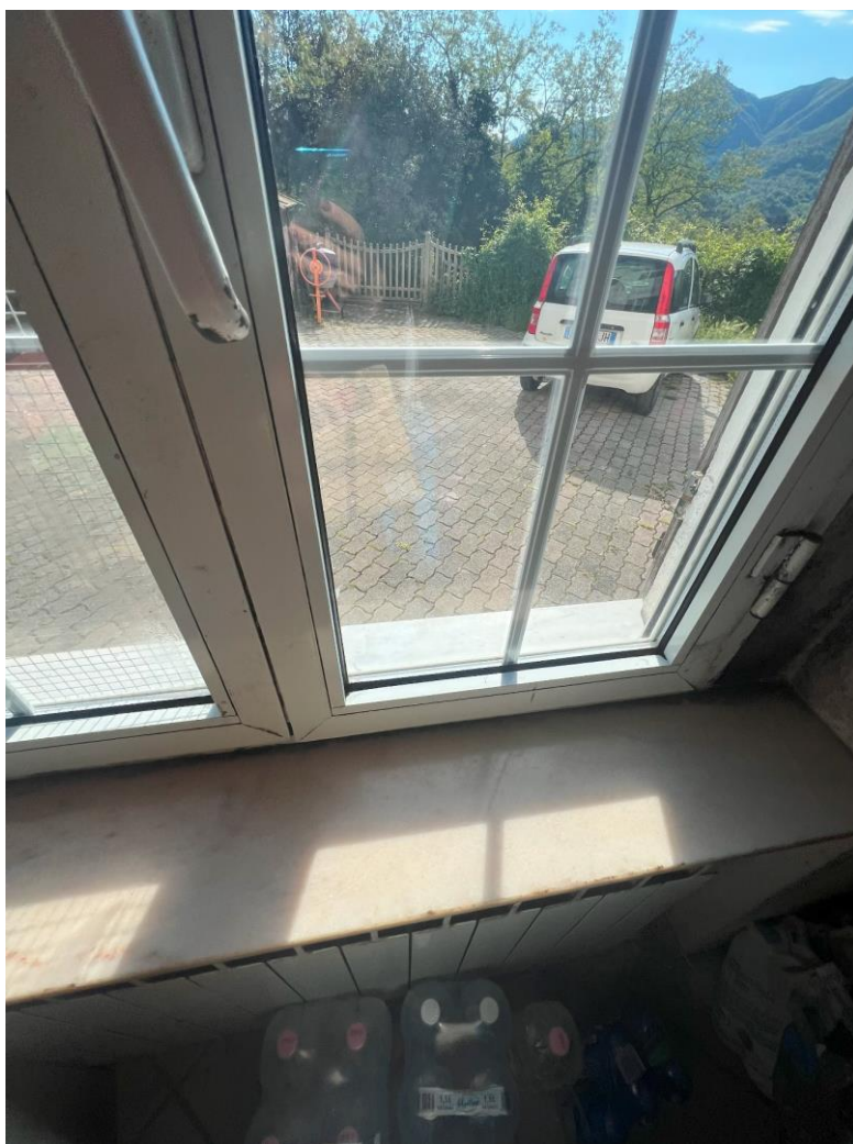
Foto n 23. - Stato degli infissi esterni
