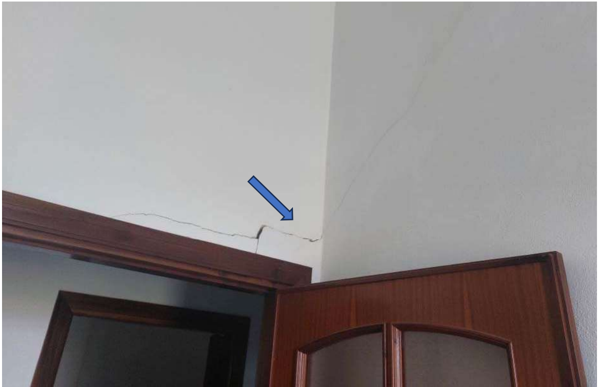
Foto dettaglio lesioni da cedimenti strutturali
