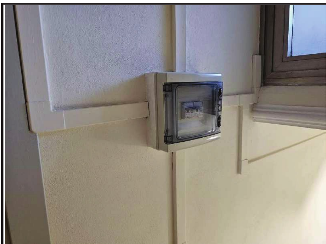
Foto n. 24 LOTTO A.1 Particolare GH001LPSLDQWR elettrico.
