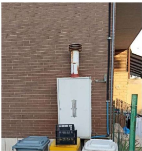
FOTO 49 – DETTAGLIO CALDAIA ESTERNA
