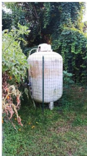
FOTO 50 – BOMBOLONE GPL ESTERNO
