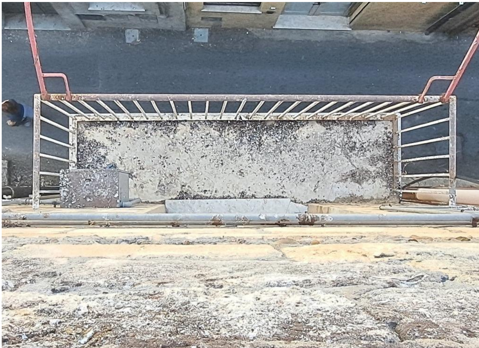
Foto 13 – balcone al secondo piano
