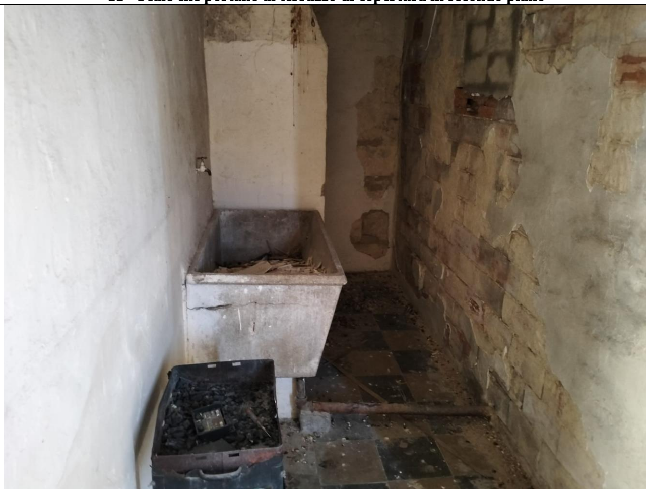
12 – Lavanderia in stato di abbandono in adiacenza alle scale ed al muro perimetrale
