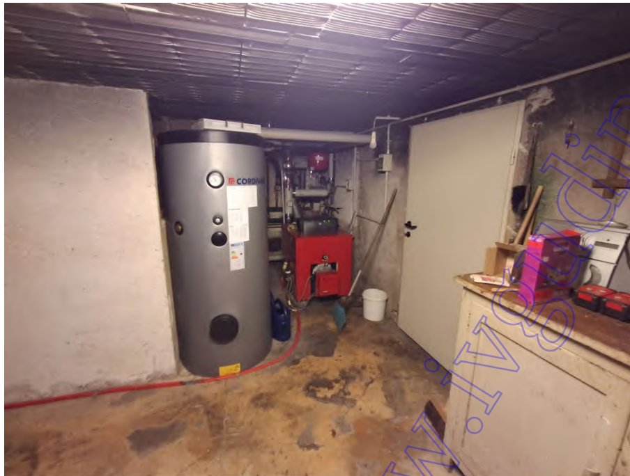
Vista locale caldaia p.t.
