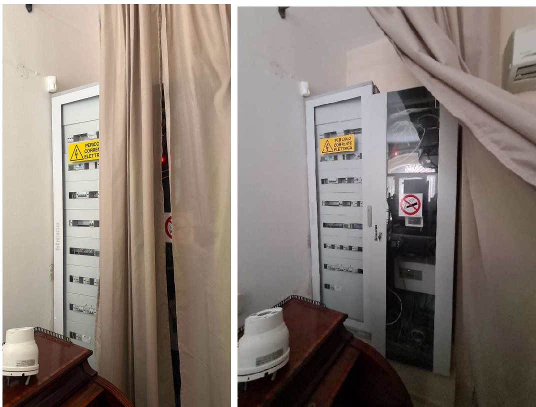
Particolare quadro impianti
