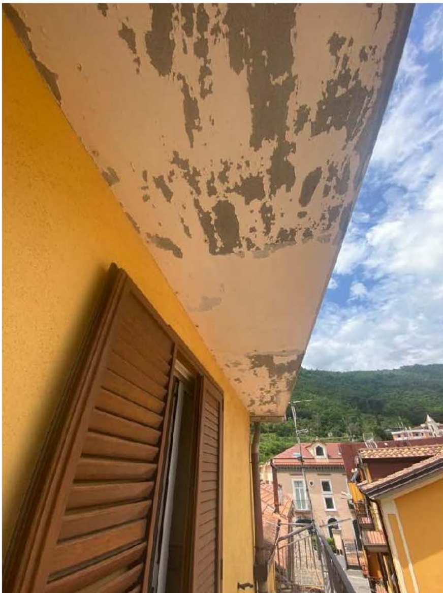
Foto n. 61: Degrado all' intradosso del balcone ad ovest in II Piano
