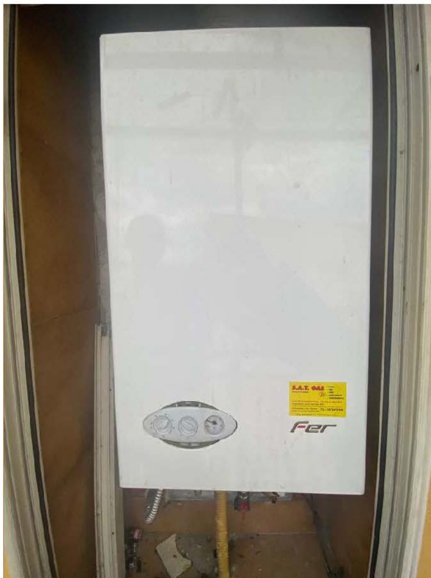
Foto n. 65: Caldaia posta sul balcone in II Piano
