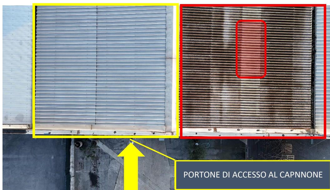
*FOCUS DELLA COPERTURA CON DRONE – NEL CONTORNO GIALLO PORZIONE DI COPERTURA RINNOVATA NEGLI ANNI - NEL CONTORNO ROSSO ZONA DI INFILTRAZIONE
