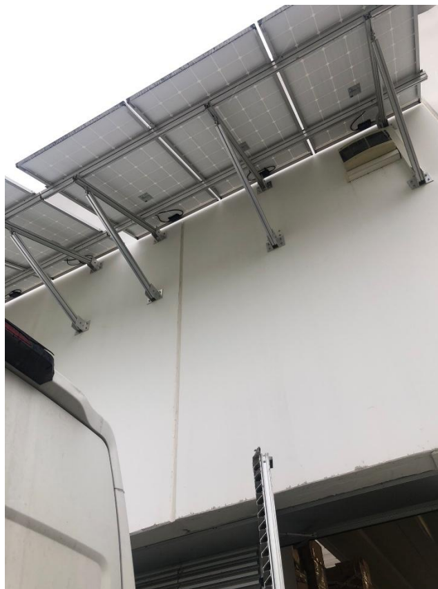
Figura 83 – Impianto fotovoltaico su lato sud
