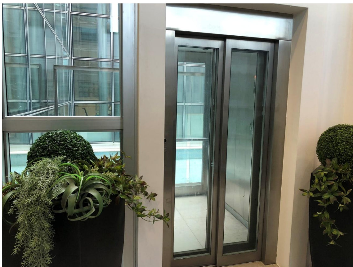
Figura 59 – Ascensore a piano terra
