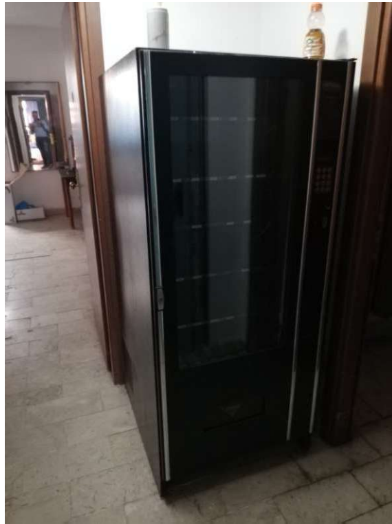
FOTO 41 - DISTRIBUTORE AUTOMATICO BIBITE E MERANDE REFRIGERATO - GUASTO
