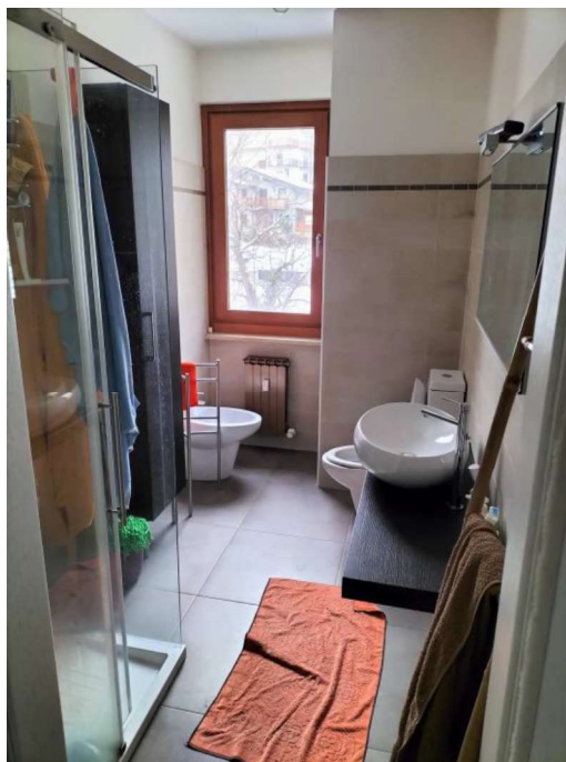
RIPRESA FOTOGRAFICA 12 EFFETTUATA DAL C.T.U. – BAGNO PIANO PRIMO
