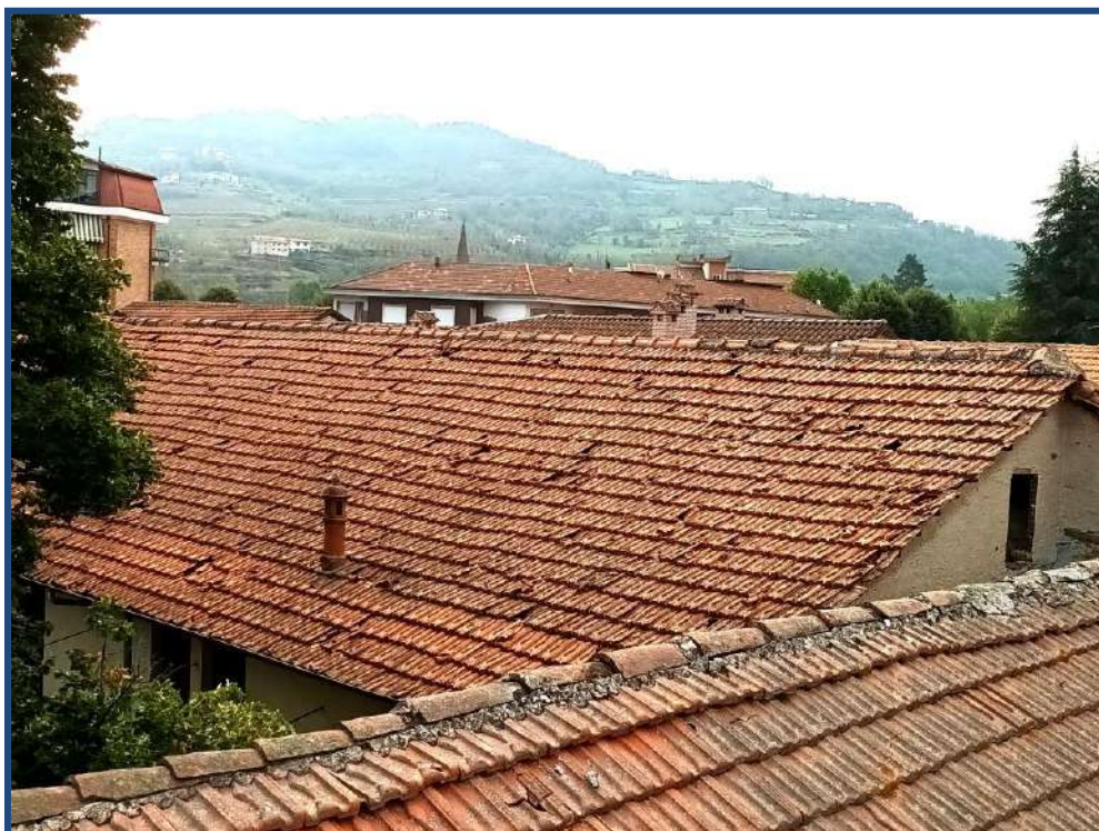
foto 53 - situazione coperture post-grandinata
