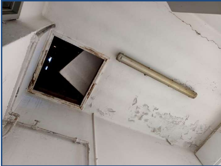
foto 40 - P.1. - Manica Sud-Est - infiltrazioni locale wc da copertura danneggiata
