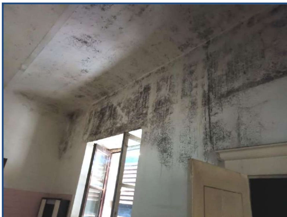
foto 37 - P.1. - Manica Sud-Ovest loc. disimpegno - infiltrazioni copertura
