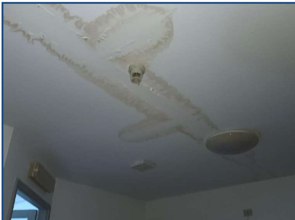
foto 27 - P.T. - Manica Nord-Ovest - bagno assistito - infiltrazioni solaio da copertura piana
