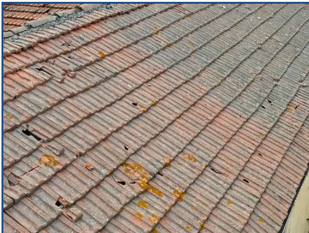
foto 54 - situazione coperture post-grandinata
