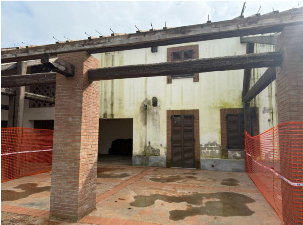
Foto 9 Prospetto nord abitazione/porticato crollato corpo A
