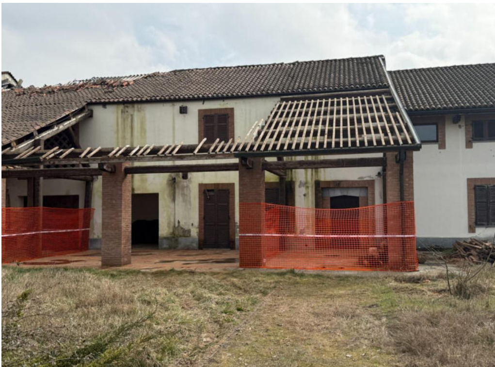
Foto 8 Tetto crollato porticato corpo A
