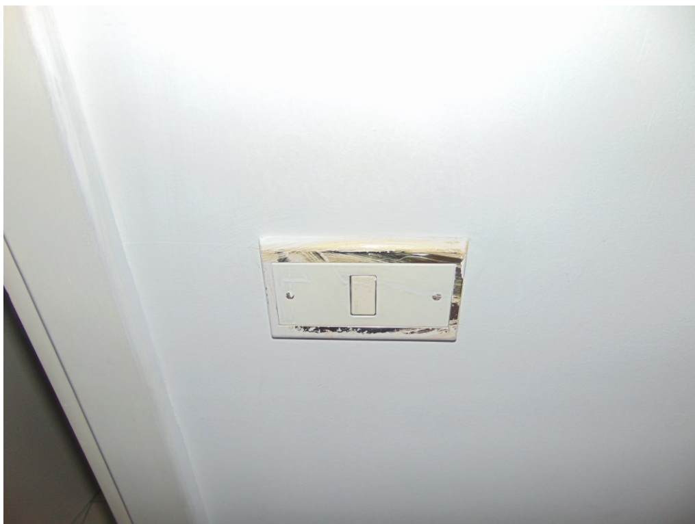
FOTO N.58: particolare interruttore elettrico a muro.
