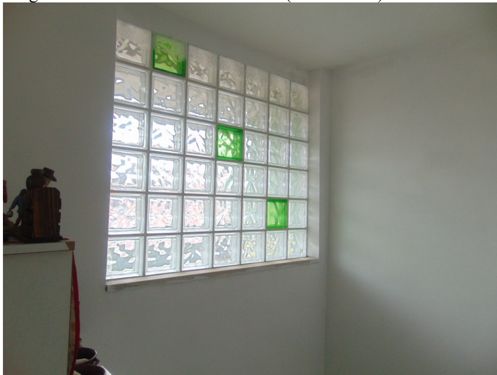
FOTO N.65: vetro-cemento sul vano scala secondo piano.
