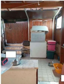
Foto n. 11 – Vista interna gazebo in legno, attualmente chiuso su quattro lati in difformità al progetto approvato, collegato al balcone dell'appartamento pignorato
