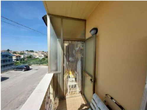
Foto n. 10 – Vista della veranda realizzata su porzione del balcone lato Nord per la quale non risultano reperite le dovute autorizzazioni edilizie
