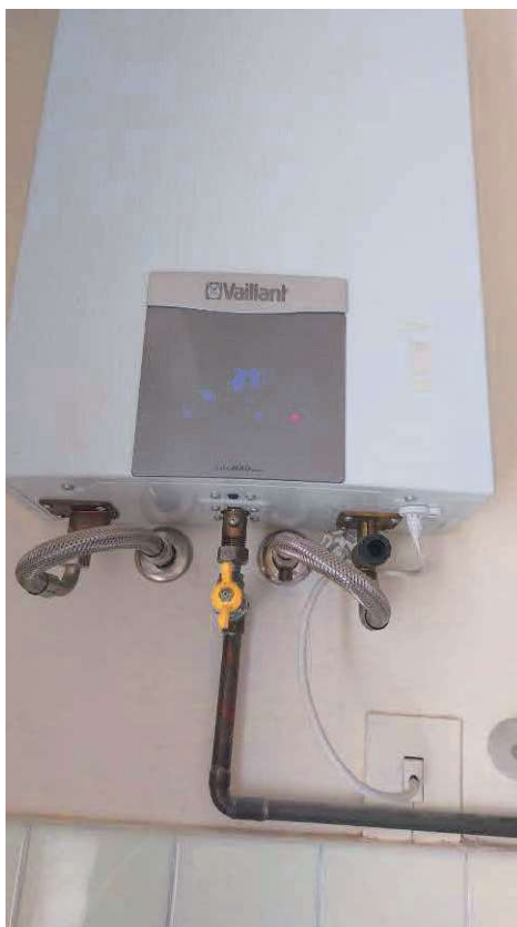
Vista del bruciatore nel servizio igienico per acqua calda sanitaria
