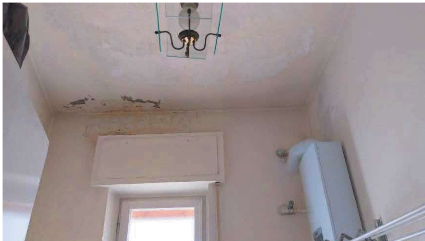
Vista delle condizioni di ammaloramento del soffitto per infiltrazioni del servizio igienico
