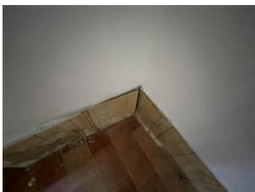
Umidità nei locali principali
