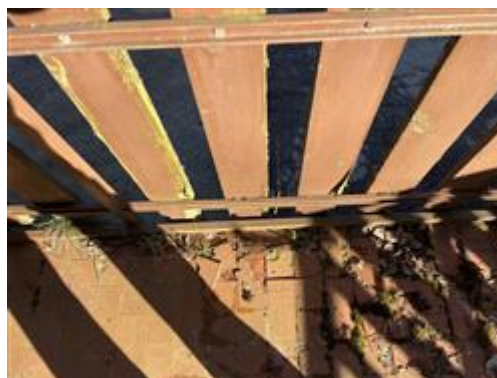
Ammaloramenti pavimentazione balcone
