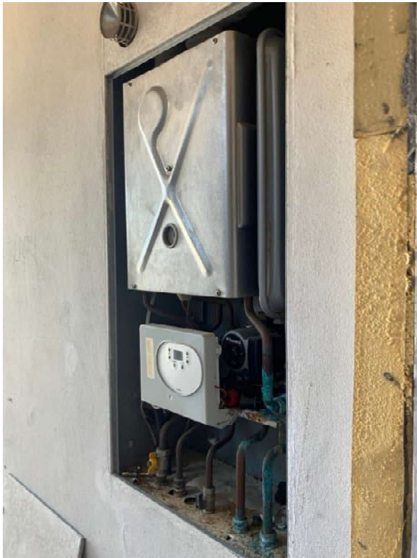
Foto 21 – La caldaia del termosingolo sul vano scala; notasi il rivestimento isolante da ultimare
