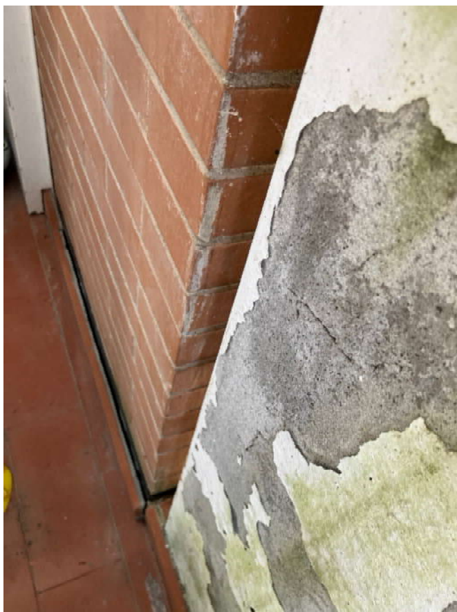
Foto 24 – Un particolare del cattivo stato manutentivo delle facciate e parti in c.a. che dovevano essere oggetto di lavori attualmente sospesi
