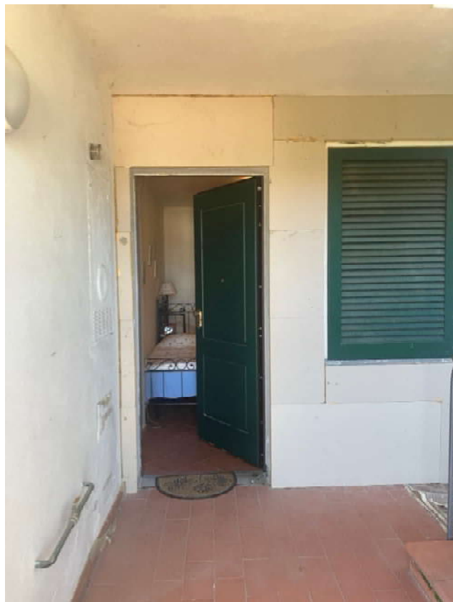
Foto 2 – L'ingresso all'unità in oggetto (residenza) dalle scale alle quali si accede dal resede comune anteriore. Notasi il rivestimento in pannelli isolanti oggetto dei lavori che risultano attualmente sospesi
