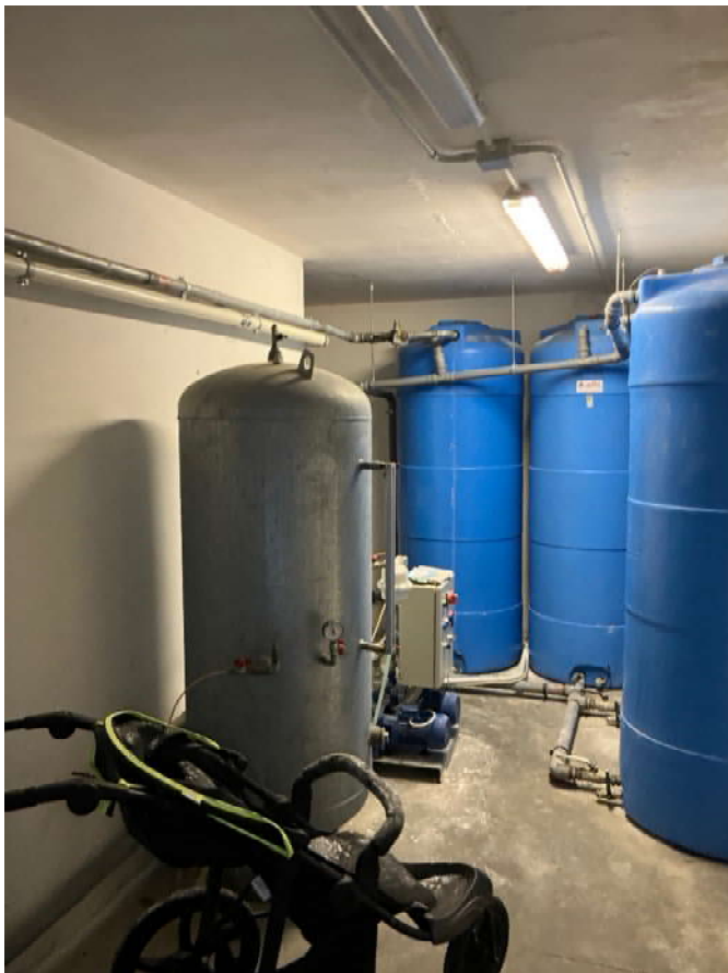
Foto 20 – Il locale autoclave condominiale
