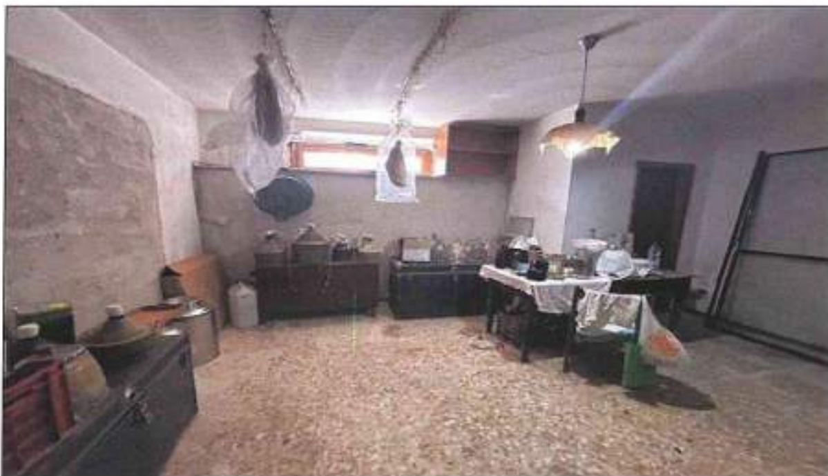
Foto n° 52 - vista interna locale macchine ed impianti.
