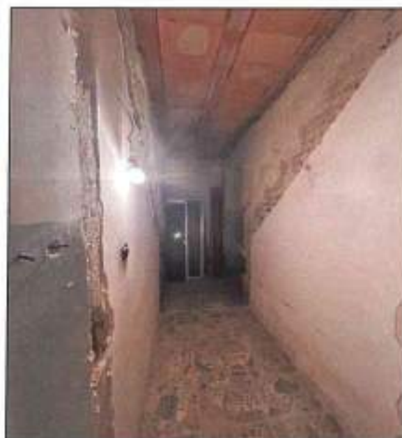
Foto n° 50 – vista interna locale corridoio al piano S1, con lavori rimasti sospesi allo stato rustico e non ancora terminati.
