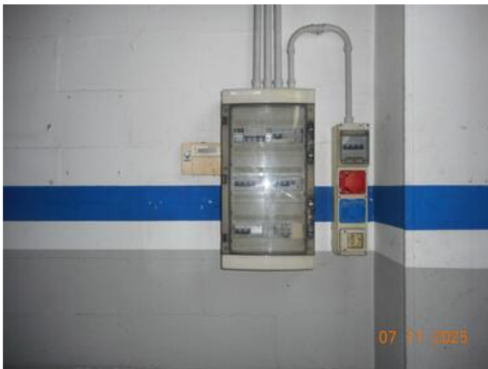
foto 14: quadro elettrico generale comune ai due civici
