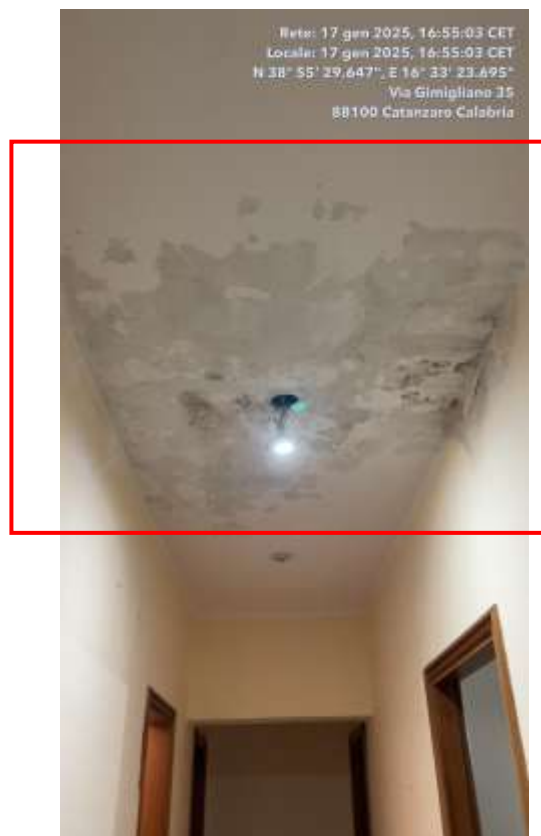
Foto 9. Infiltrazioni d'acqua nel corridoio
