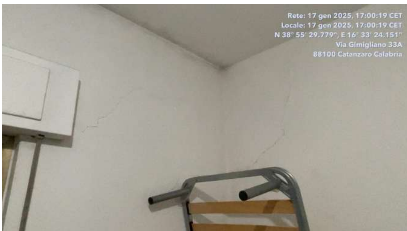
Foto 28. Lesioni rilevate sulle pareti esterne
