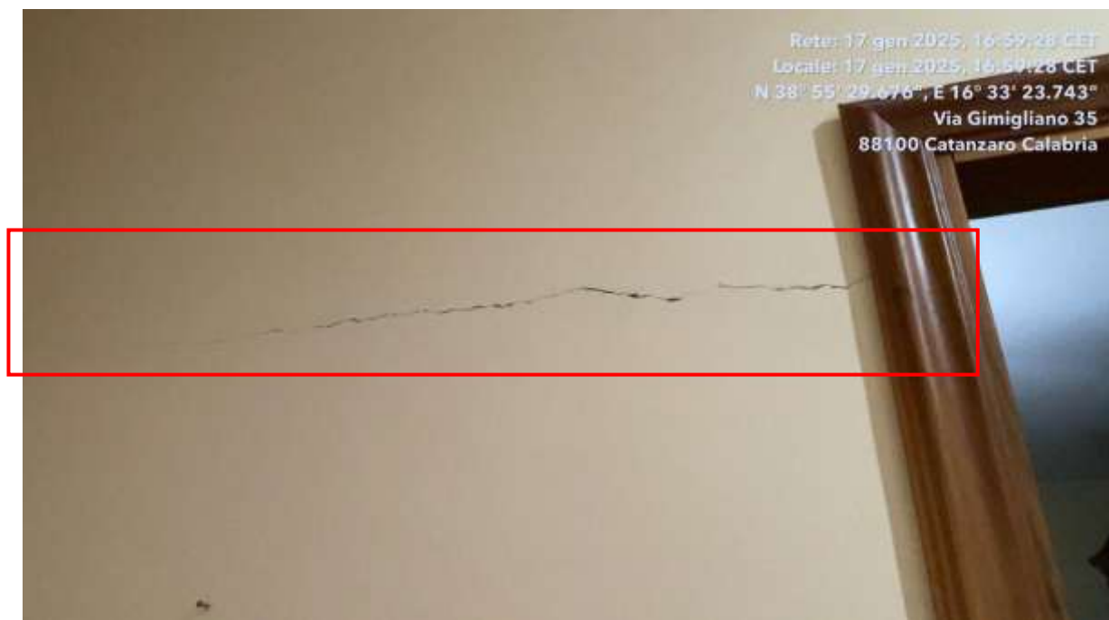
Foto 11. Lesioni lungo la parete del corridoio
