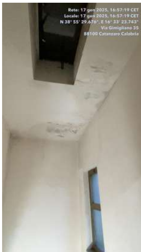
Foto 31. Tracce di infiltrazioni ed umidità all' interno del vano scala
