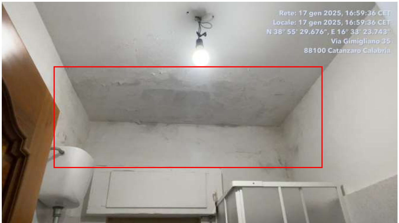
Foto 14. Particolare macchia di umidità e/o infiltrazioni dalla sovrastante copertura
