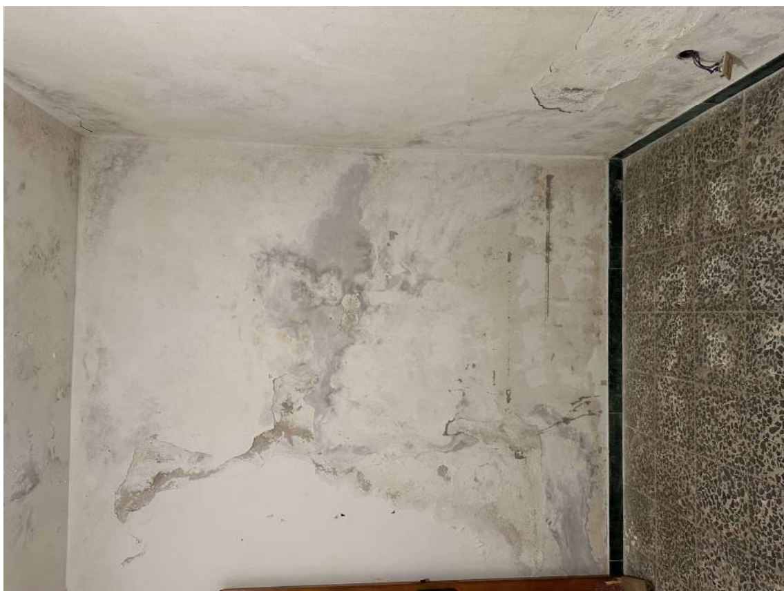
Foto 30 – umidità pareti camera da letto 2
