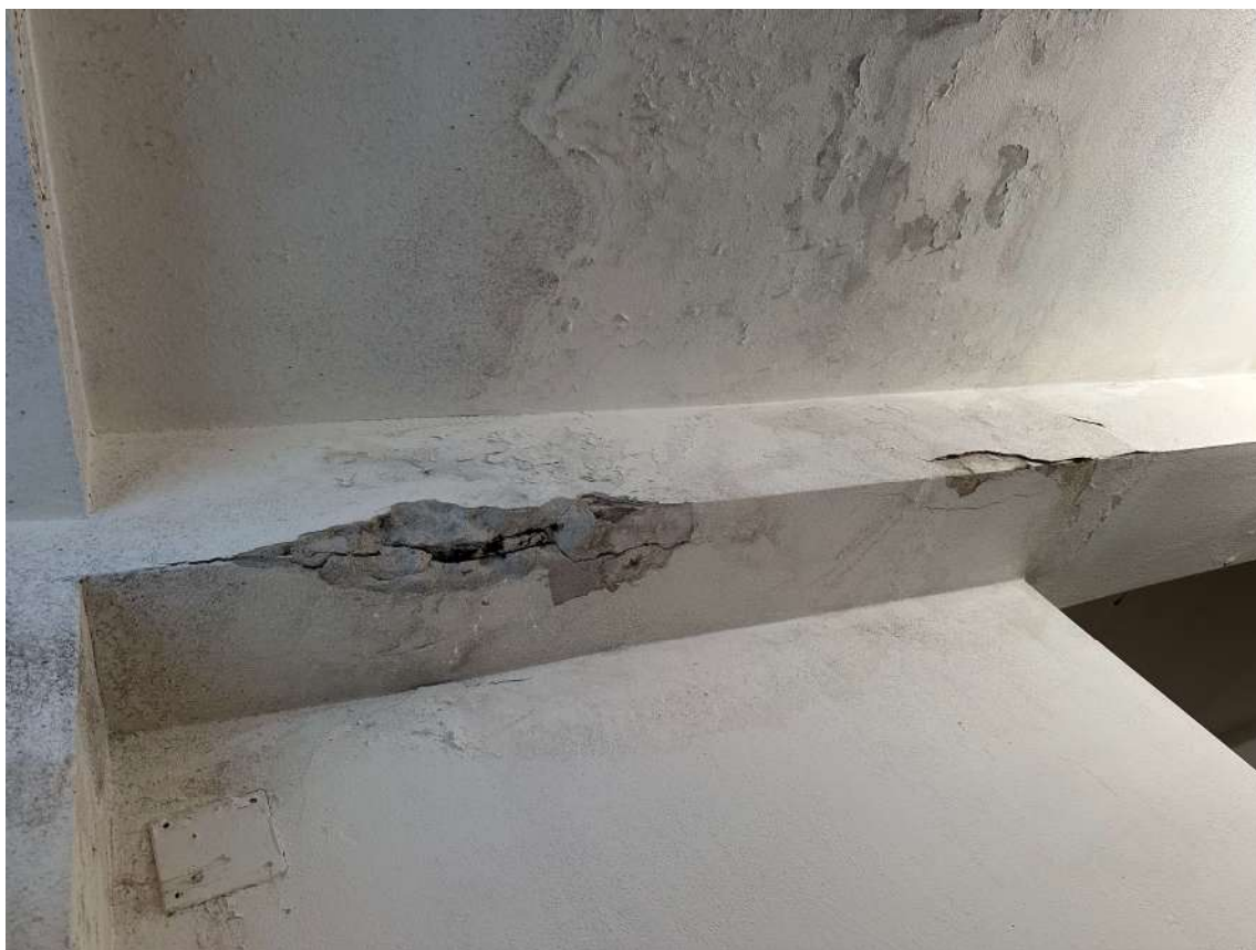
Foto 13 – umidità soffitti piano terra
