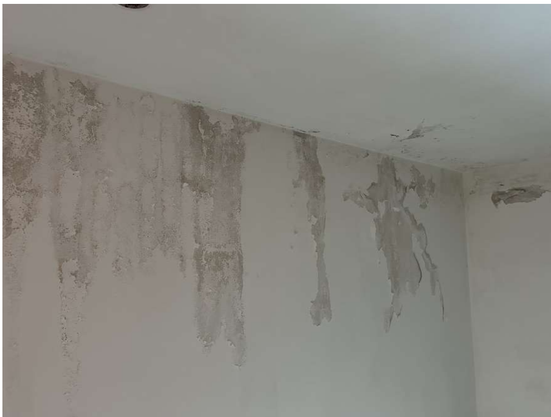
Foto 17 – umidità pareti e soffitti
