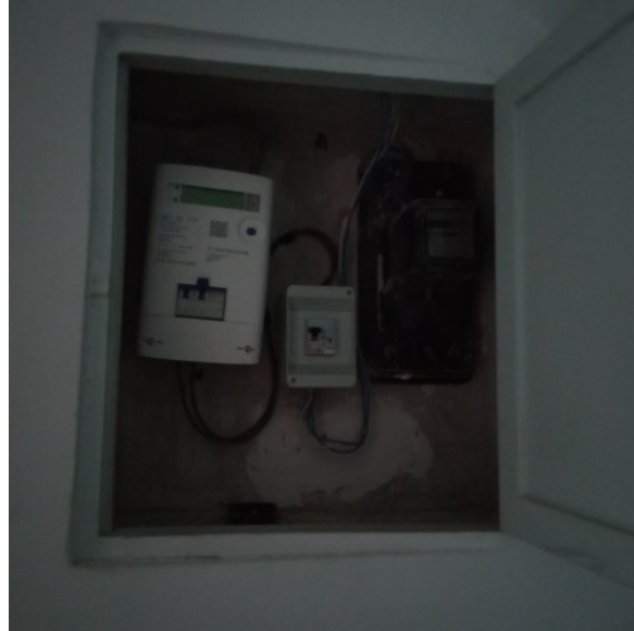
Contatore corrente elettrica - vano scala
