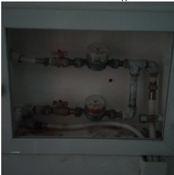
Contatore parziale dell'acqua
