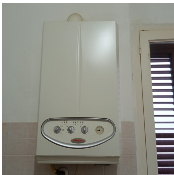
Caldaia gas - cucina
