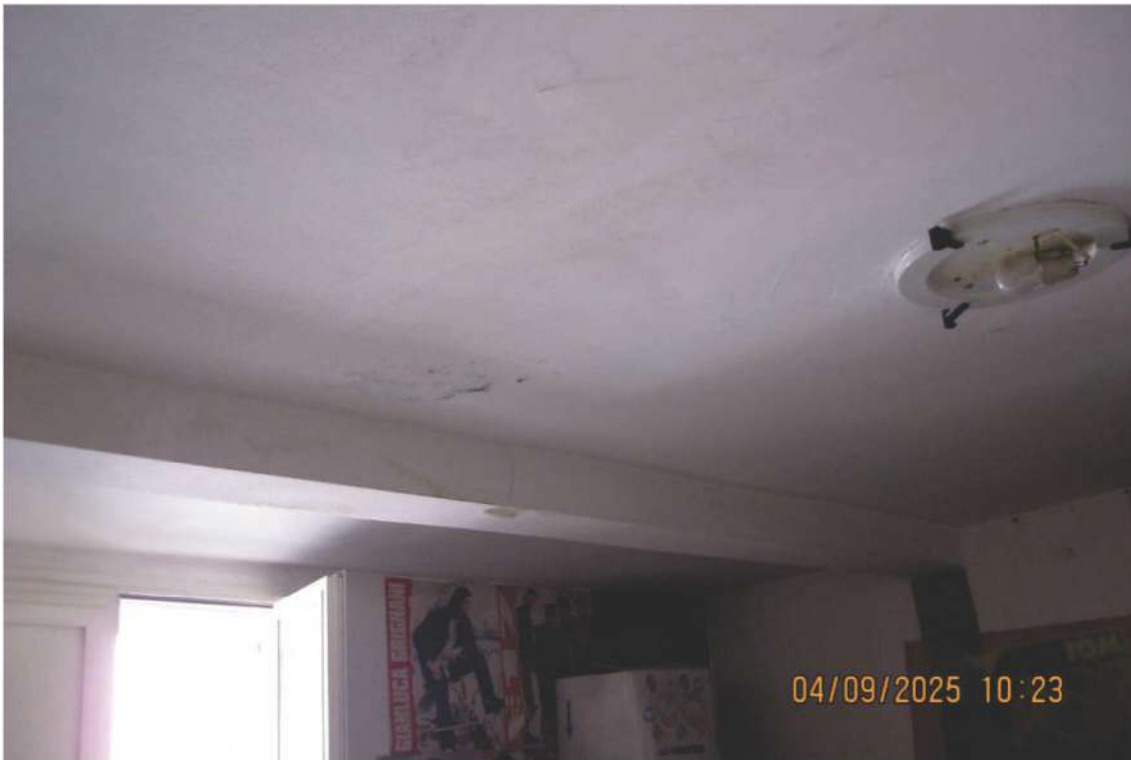
Foto 34: particolare del solaio del vano a secondo piano; si notino le macchie di umido ed infiltrazioni
