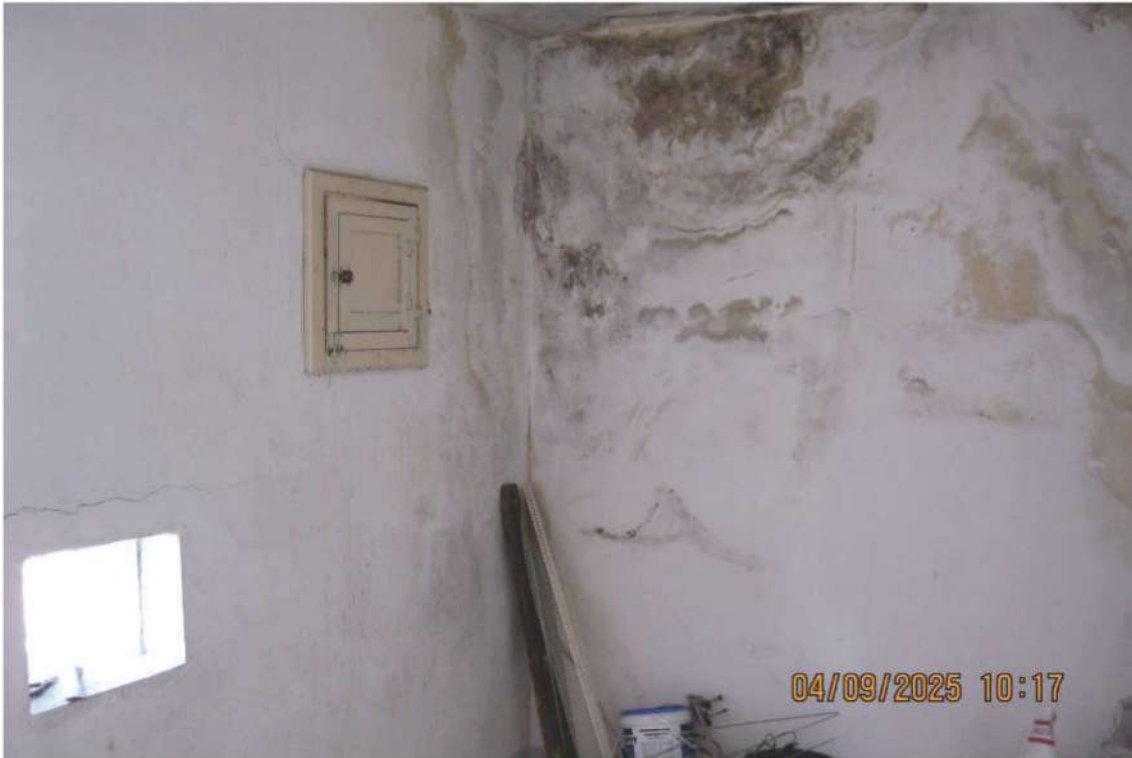
Foto 42: altra rappresentazione fotografica del vano del terzo piano; si notino le macchie di umido ed infiltrazioni
