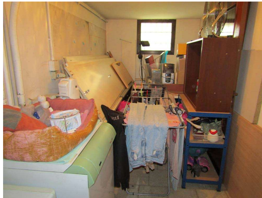
Foto 30: vista del locale centrale termica al piano seminterrato
