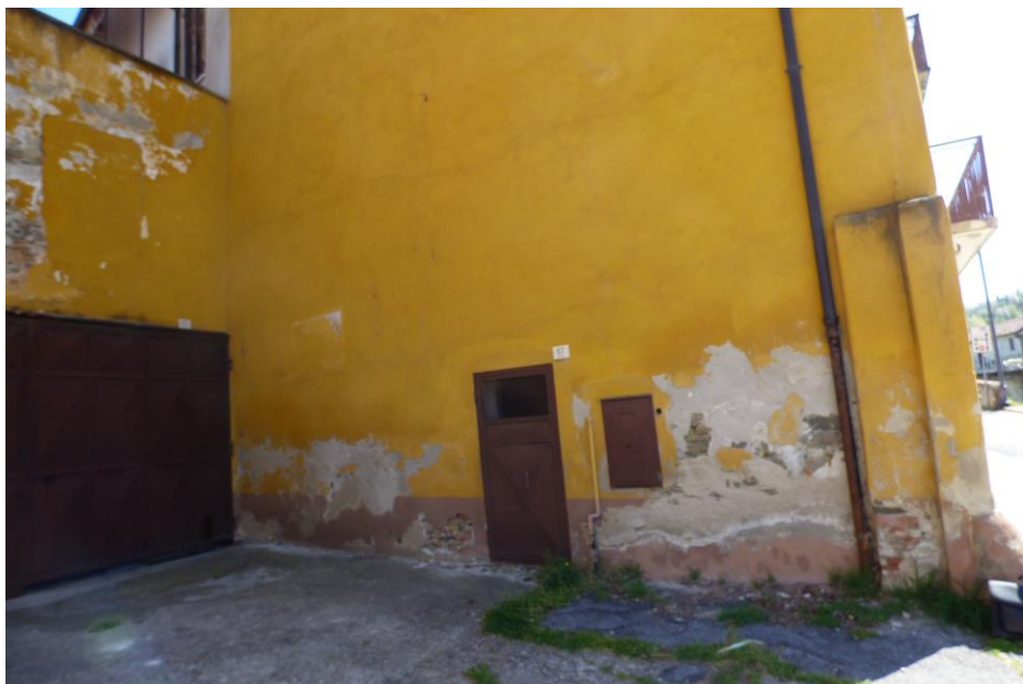
Ingresso C.T. SUB 12
