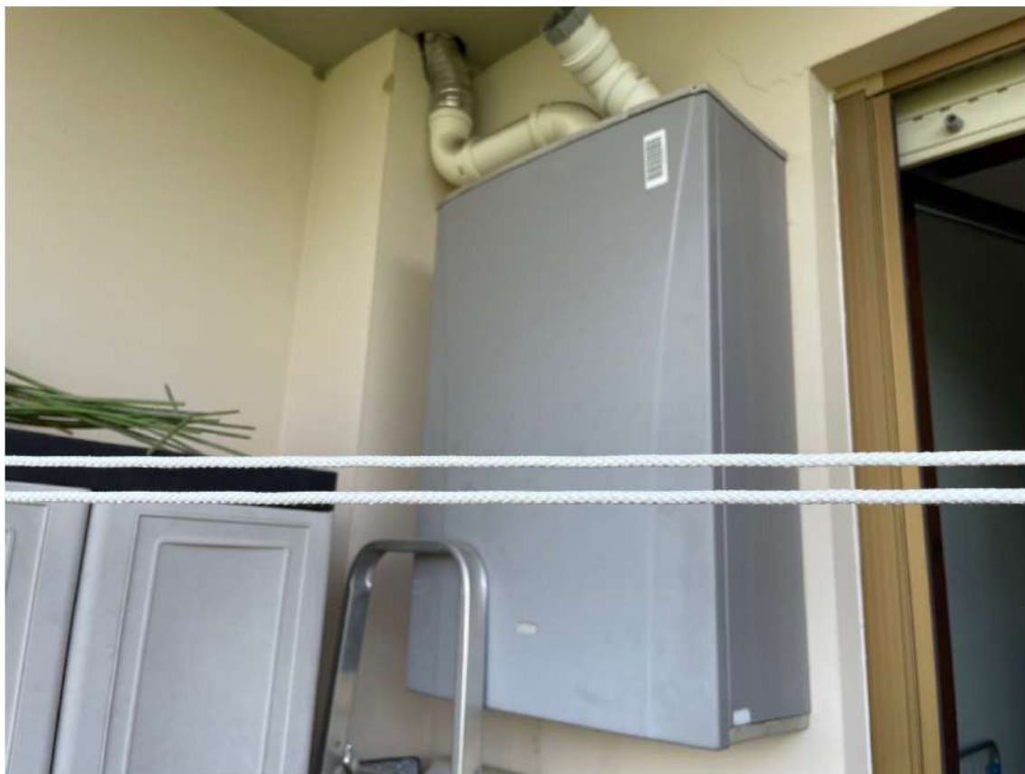
Vista caldaia posta nel balcone
