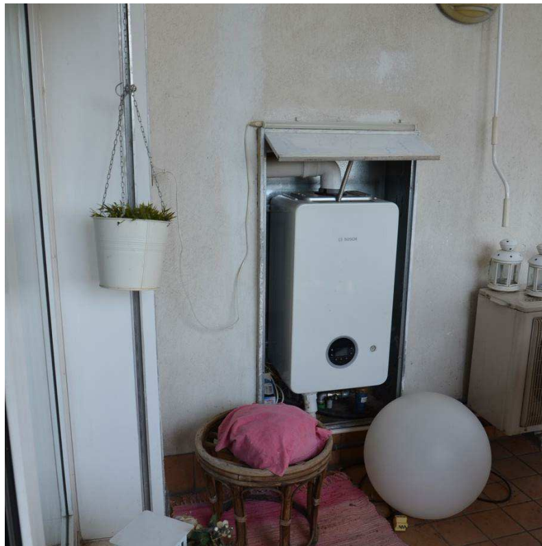
Caldaia in terrazza piano primo
