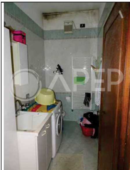
Foto n°29: Lavanderia cieca non concessionata
