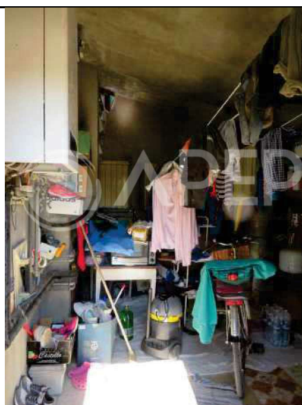
Foto n°34: Centrale termica a nord est
