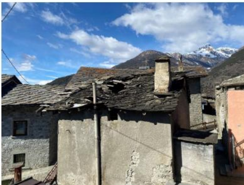
Vista esterna del fabbricato di vetusta edificazione, in condizioni critiche, con vista del tetto dove si vedono evidenti segni di crollo, prima degli interventi di ripristino.
