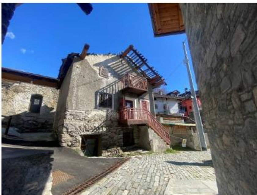
Vista esterna del fabbricato di vetusta edificazione, prima di essere messo in sicurezza, in condizioni critiche dove a destra, vi è il piccolo terreno adibito a corte, dove è stata successivamente pignorata.
