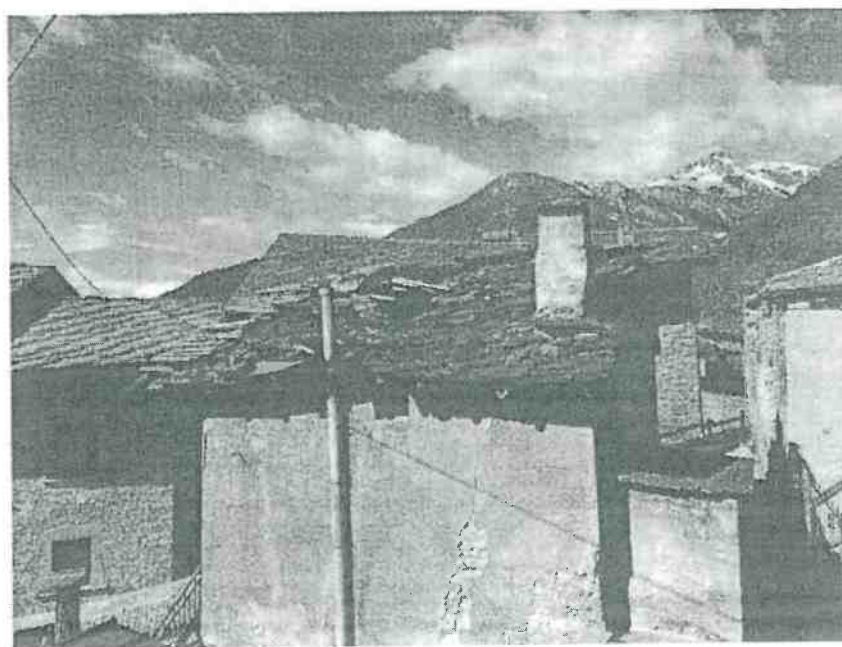
Vista esterna del fabbricato di vetusta edificazione, in condizioni critiche, con vista del tetto dove si vedono evidenti segni di crollo.
