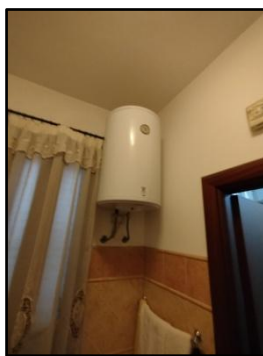
Boiler W.C. P. 1°
