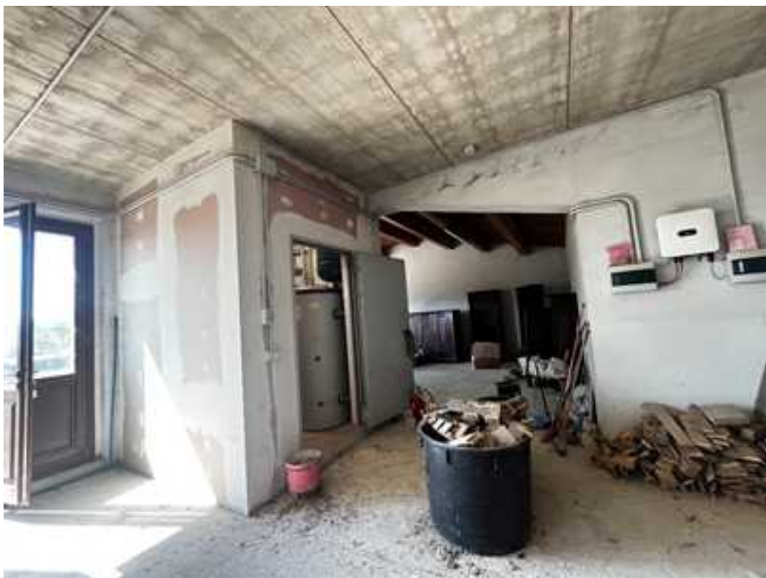
FOTO 11: PARTICOLARE VISTA OVEST DEL DEPOSITO AL DI SOTTO DELL'ABITAZIONE- CENTRALE TERMICA
