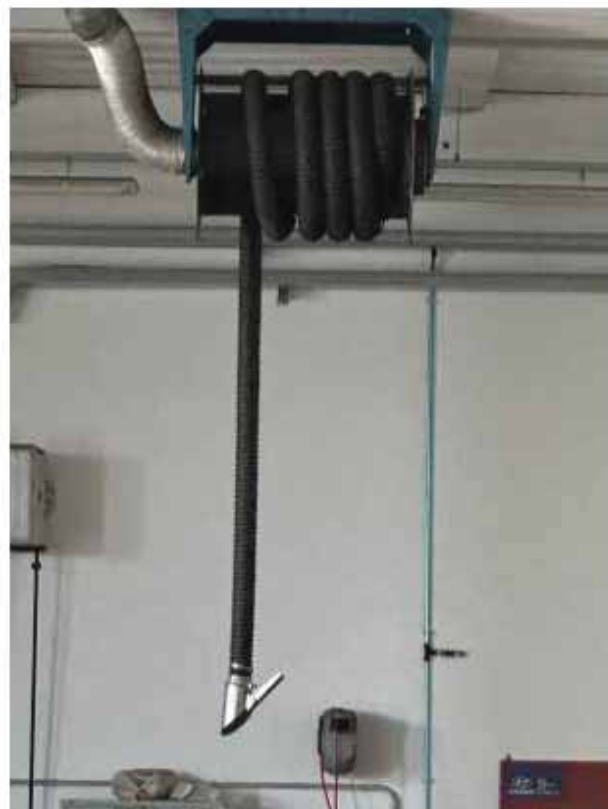
ID 0297 + 0298 + 0299 + 0300 aspiratore gas di scarico con raccoglitore di cui uno scorrevole su guida aerea
