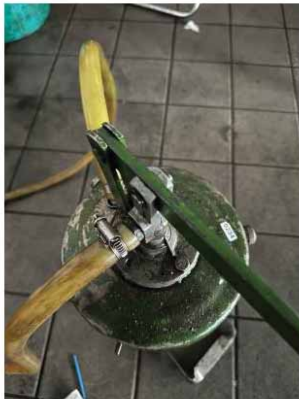
ID 0233 + 0234 Pompa travaso olio lubrificante LSD
