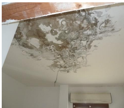
Foto 19 Vano letto 2 - Infiltrazioni
