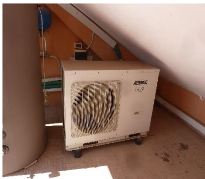
Foto 31 – Alloggiamento motori Pompe di calore
