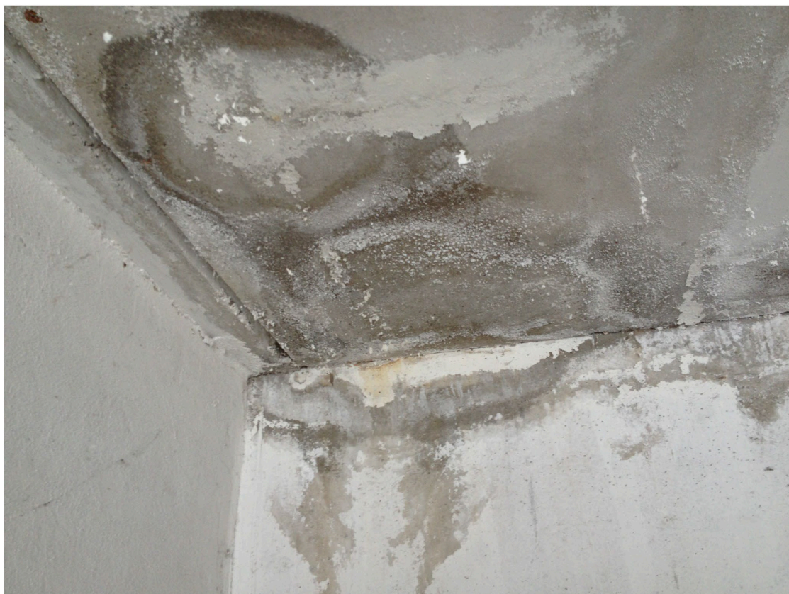
Figura 4 - Tracce di infiltrazione e degrado degli intonaci interni.
