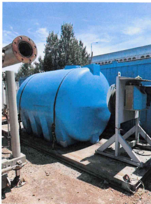
Foto 6 — Serbatoio (cisterna) di accumulo acqua/fanghi di perforazione su pattino metallico, con avvolgicavo e quadro elettrico di alimentazione: componente riconducibile al n. 2 (Container magazzino e ricambi) / attrezzature accessorie all'impianto.
