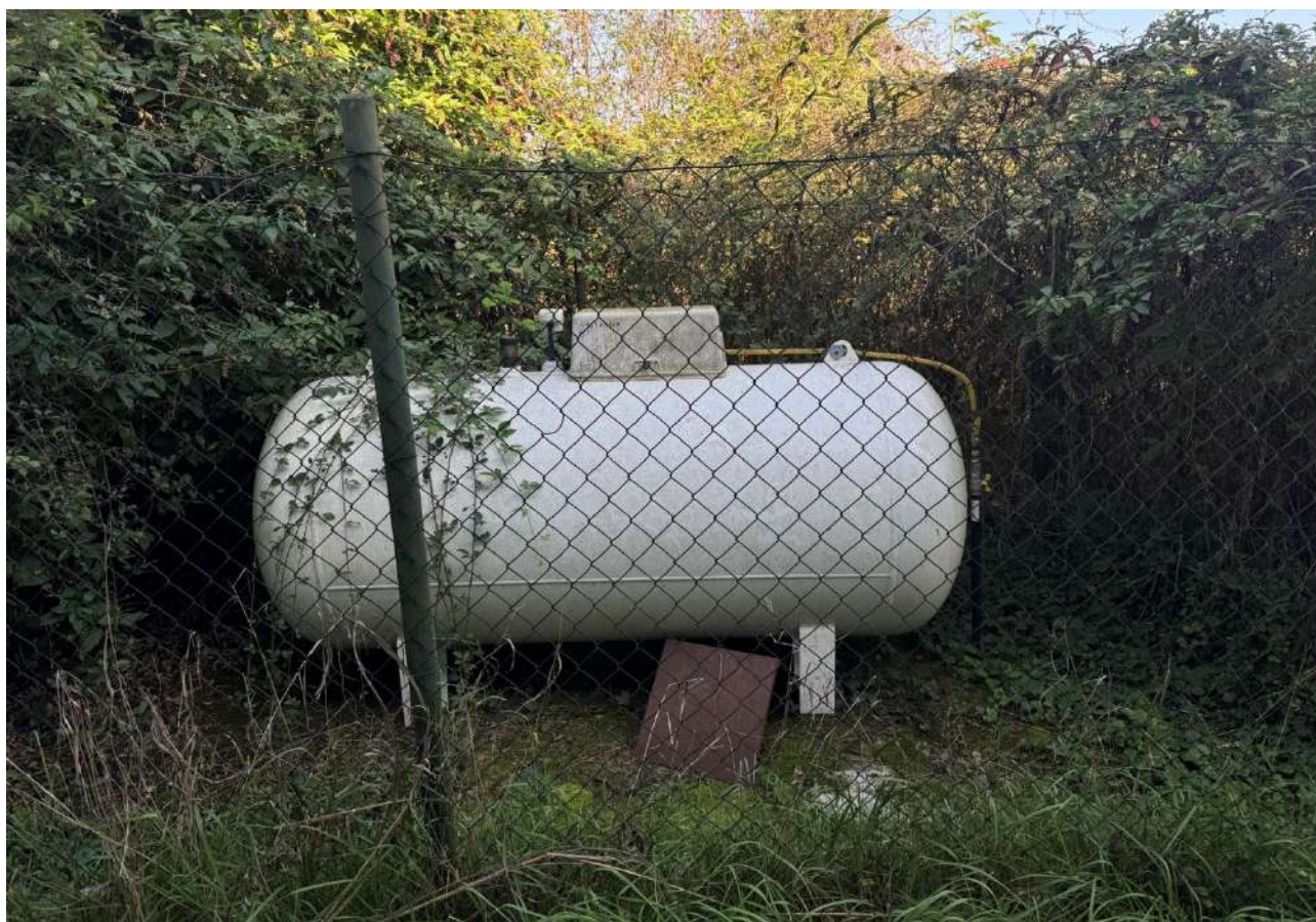
53. Recinto con bombolone del gas GPL.
