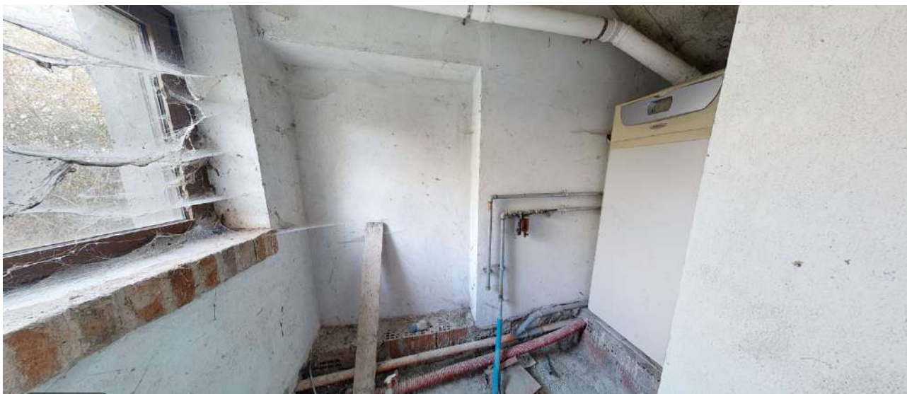
32. Sottoscala con caldaia (sub. 5-piano terra).
