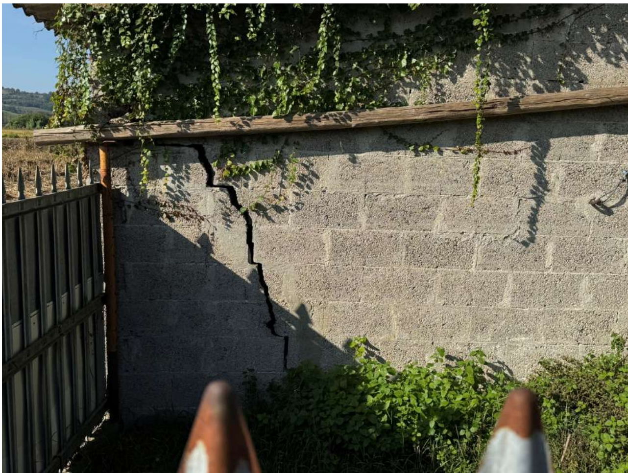
50. Fessurazione nella muratura in blocchi del basso fabbricato.
