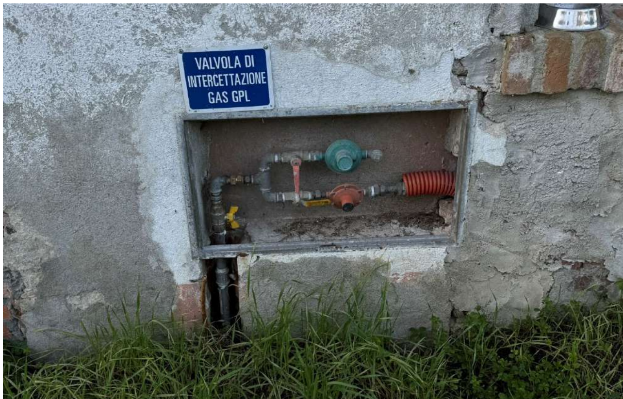
52. Valvola d'intercettazione del gas GPL.
