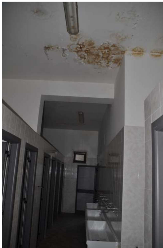
Servizi igienici : macchie evidenti di infiltrazioni
