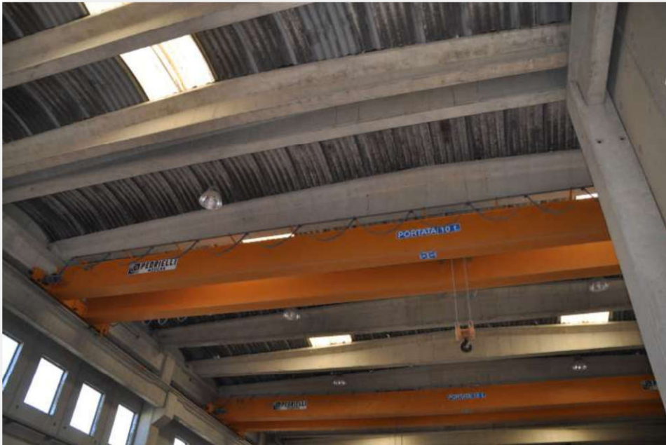
Copertura : segni di infiltrazioni d'acqua
