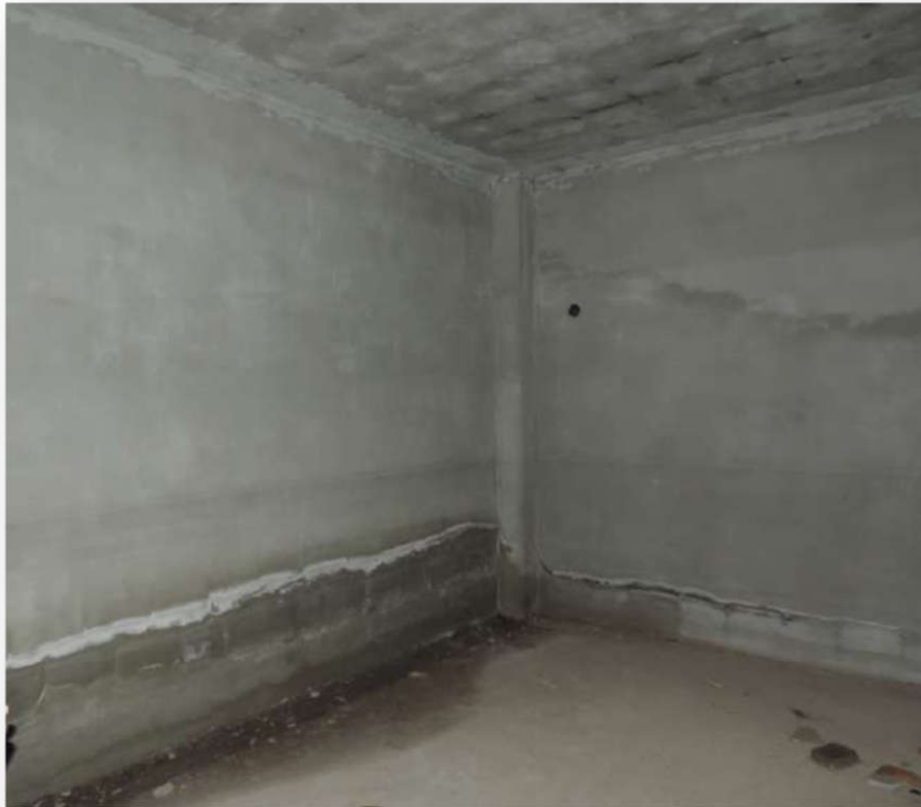
Piano cantinato : segni evidenti di infiltrazioni d'acqua
