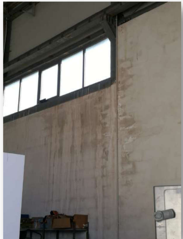
Infiltrazioni d'acqua provenienti dagli infissi a nastro
