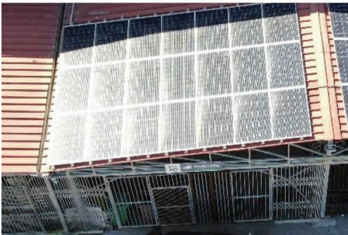
Foto 13 – n° 21 pannelli fotovoltaici per impianto fotovoltaico di 15 kW
