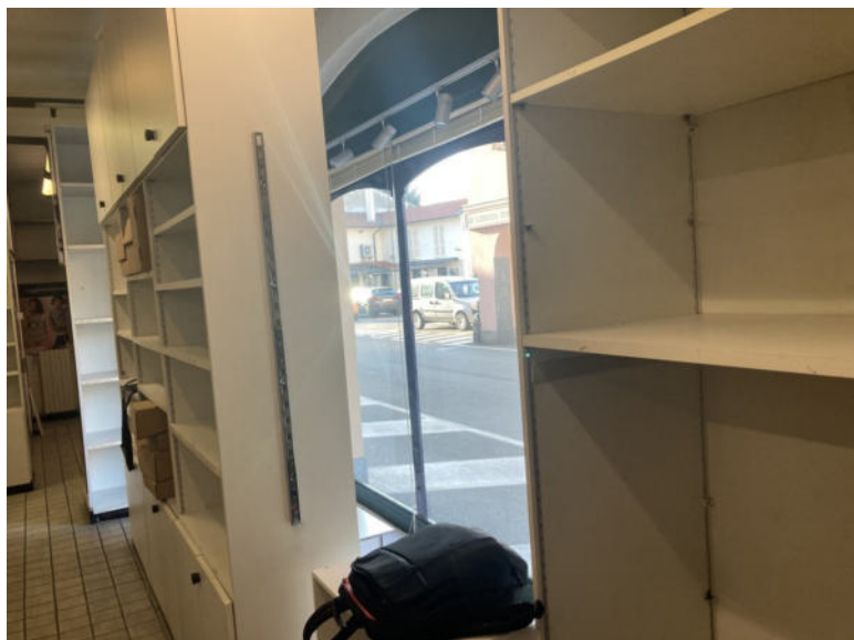
Interno negozio zona vetrina
