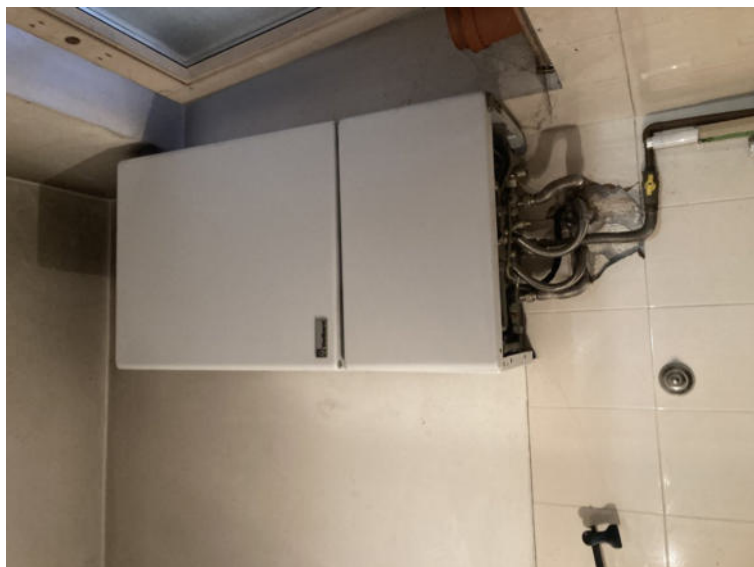
Interno negozio caldaia a parete bagno
