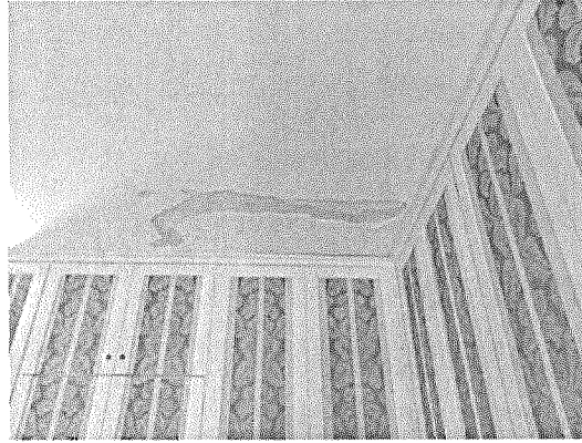
d) Porzione di solaio degradato
