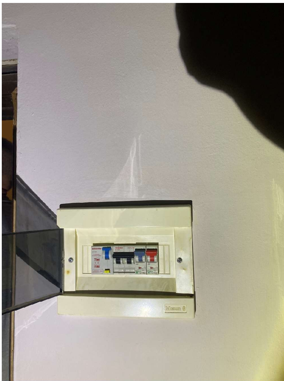
Vista quadro elettrico dell'appartamento
