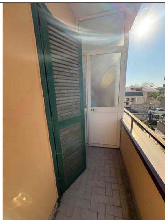
Fotografia n. 6 _ Balcone nord con deposito
